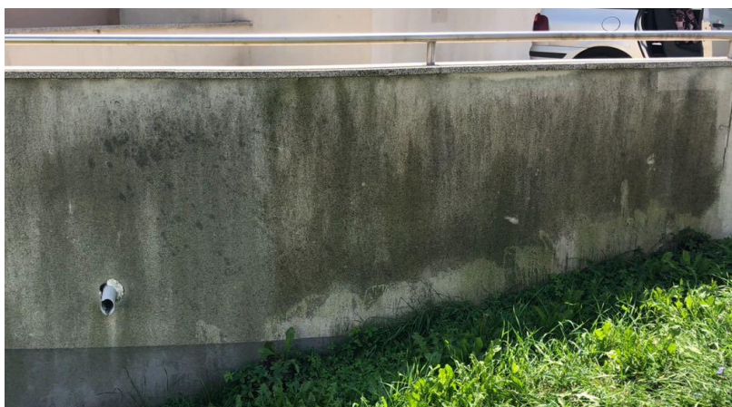
Popis fotografie: Zaplesnivý obvodový múrik bytového domu
